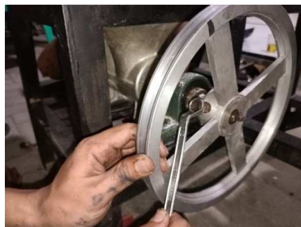
Gambar 4.25 Pemasangan puli pada pencetak pelet
