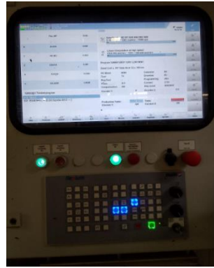
Gambar 2. 2 Panel kontrol utama
