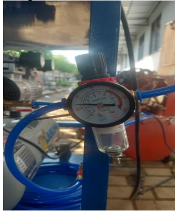
Gambar 3. 23 Penyetingan Bar Kompresor
