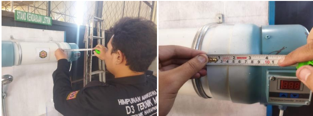
Gambar 4.23 Pengukuran Panjang Skat Water Heater
