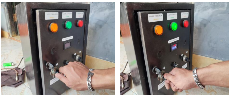
Gambar 4. 21 Menyalakan box panel dan indikator jika box panel sudah menyala
